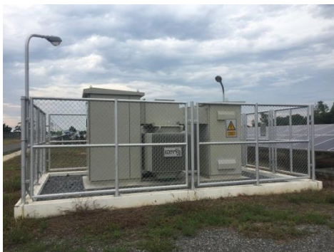
หม้อแปลงไฟฟ้า (Transformer)
